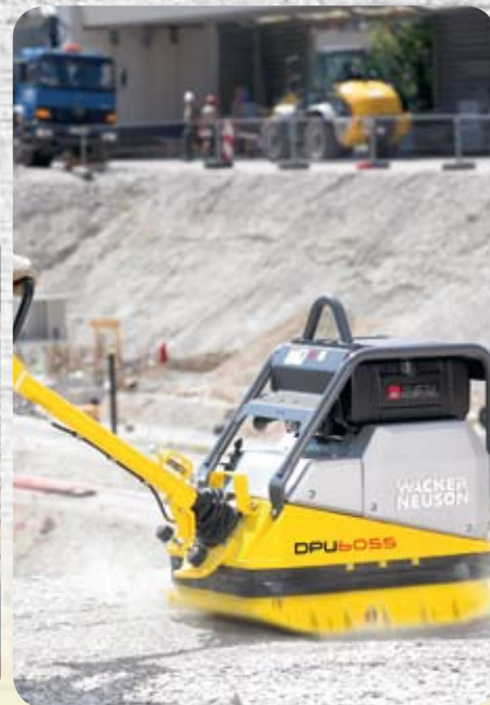
Trin 2: Jorden forberedes og komprimeres for den videre forarbejdning. Afhængigt af fladens størrelse har Wacker Neuson et bredt udvalg af vibrationsplader i sortimentet.
