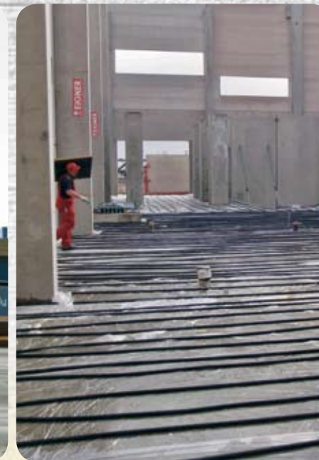
Trin 9: Efterbearbejdningen forhindrer, at betonen afkøles og tørrer for hurtigt under hærden. Overfladvärmeren E 700M fra Wacker Neuson er ideelt egnet til denne proces, da den garanterer en stabil afbindingsproces med sin fladedækkende opvarmingskraft.
