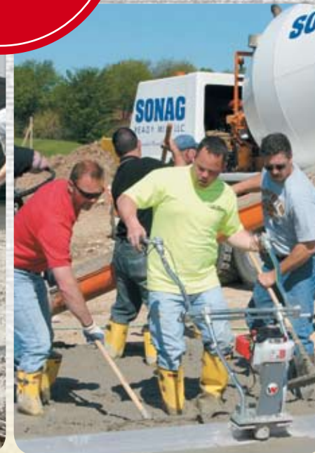
Trin 7: Med vibratorbjælken sikres det, at betonfladen er plan, og at den krævede højde overholdes. Så er gulvet optimalt forberedt til anvendelsen af glittemaskinerne.
